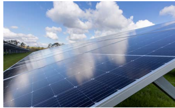
Die PV-Freiflächenanlage in der Südheide produziert Solarstrom für die Region.
