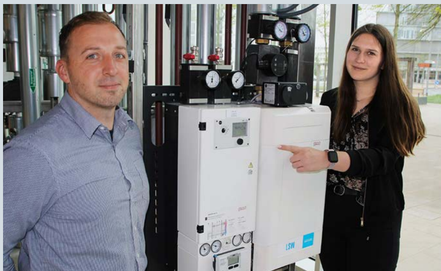
Steven Päper und Fenja Trautmann vom Technischen Kundenservice der LSW neben einer Fernwärme-Übergabestation.
