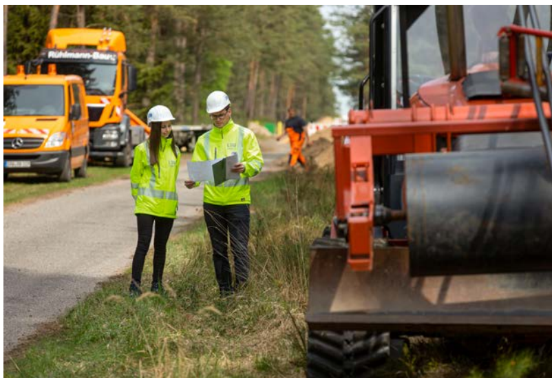
Alles unter Kontrolle: Jessica Schmidt und Niclas Wunnenberg beaufsichtigen die Baumaßnahme in Knesebeck.
